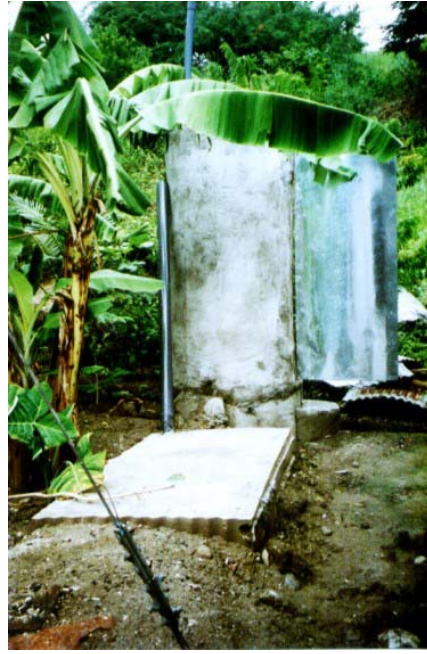
Converted toilet: pour flush plus leaching pit (local septic tank)
