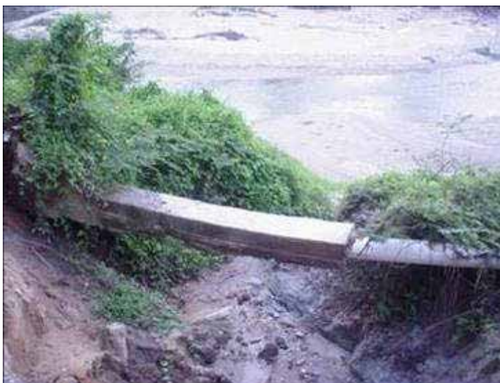
Fotografía 3: daños causados por el río Bañaderos.
