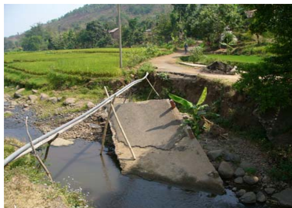
Kemiri Jembatan Pipa Air Bersih yang Terkesan Masih Darurat
