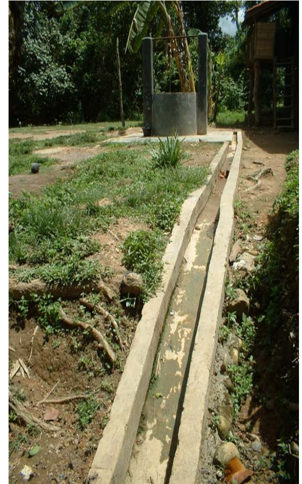
Kualitas Pekerjaan Saluran Limbah yang Masih Kurang Rapi & Arah Aliran Tidak Jelas
