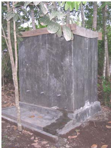
Bak Penampung Air
