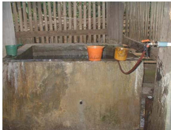
Jaga Semi Permanen, dinding Kamar Mandi Kurang Tertutup & Posisi Kran-Bak Air yang Tidak Berhubungan
